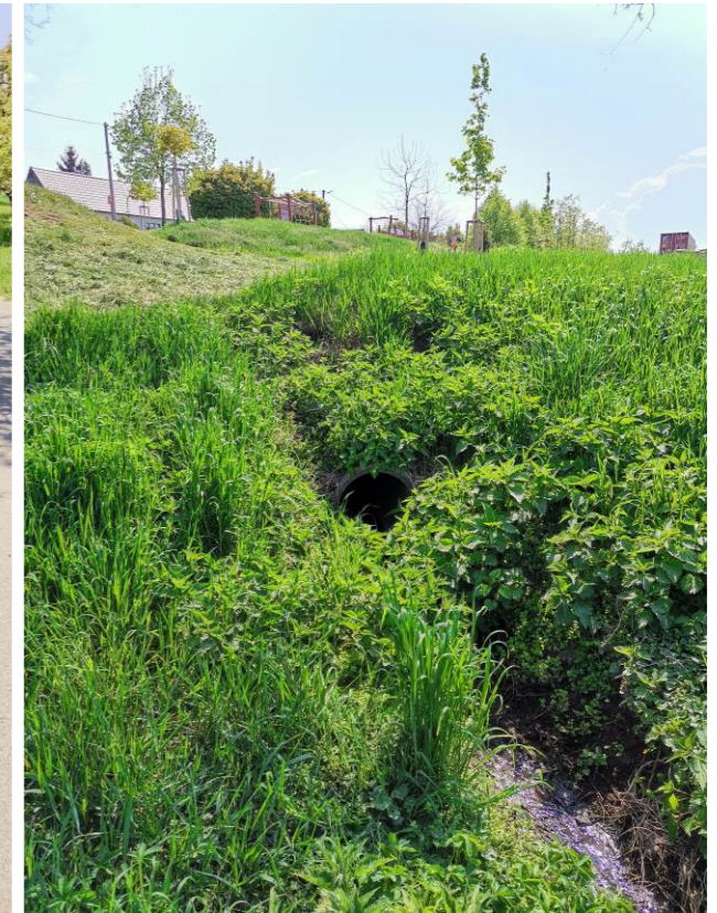
vyústění stoky IV.b
